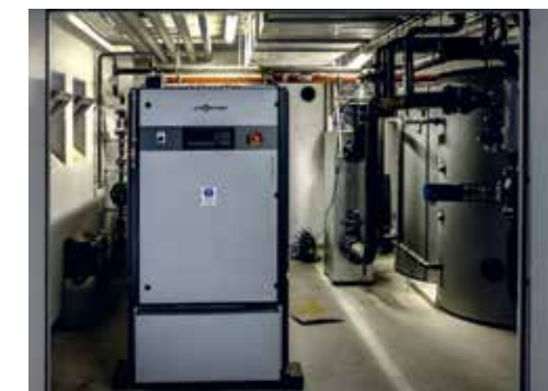
Das BHKW im Keller des Rathauses Planegg leistet ganze Arbeit.
