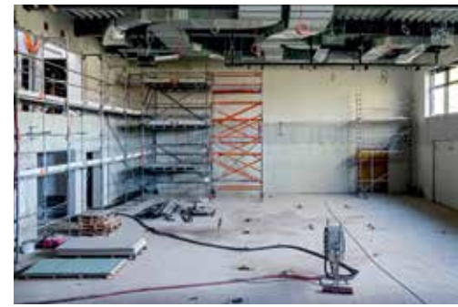
Noch muss sie trocknen: die Turnhalle der Grundschule.
